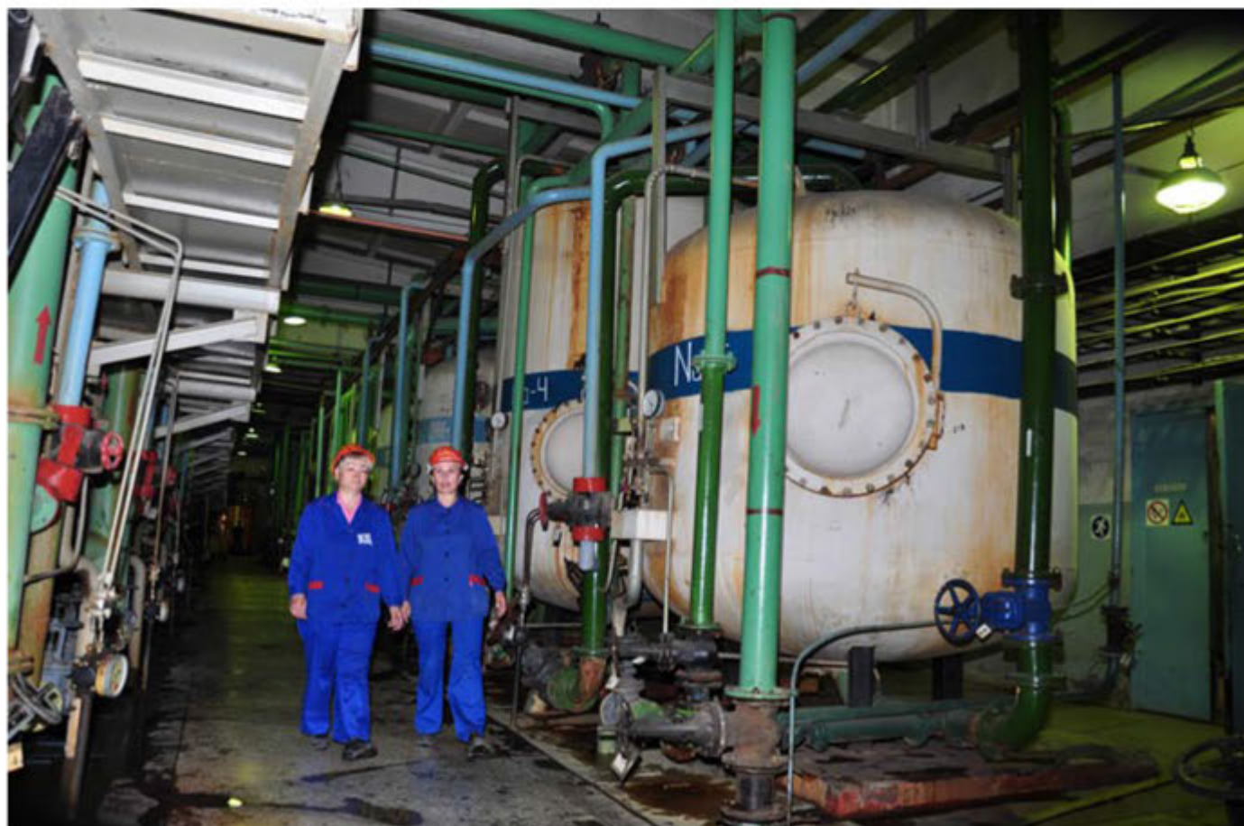
Фильтровальный зал химической водоочистки химического цеха
