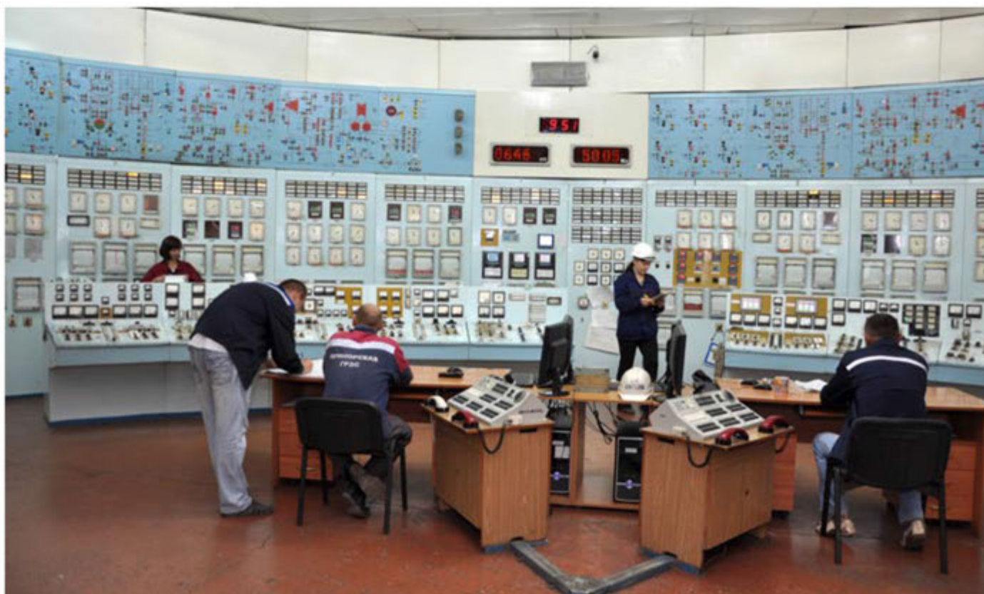
Щит управления работой турбины
