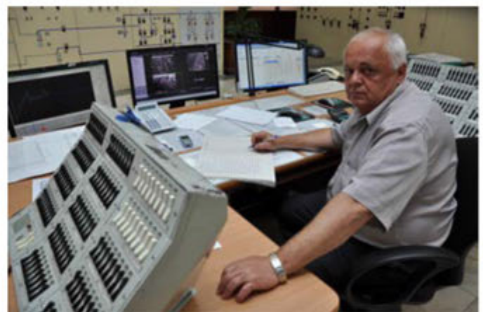
Главный щит управления работой станции Угольная. Начальник смены станции Николай Иванович Киселев
