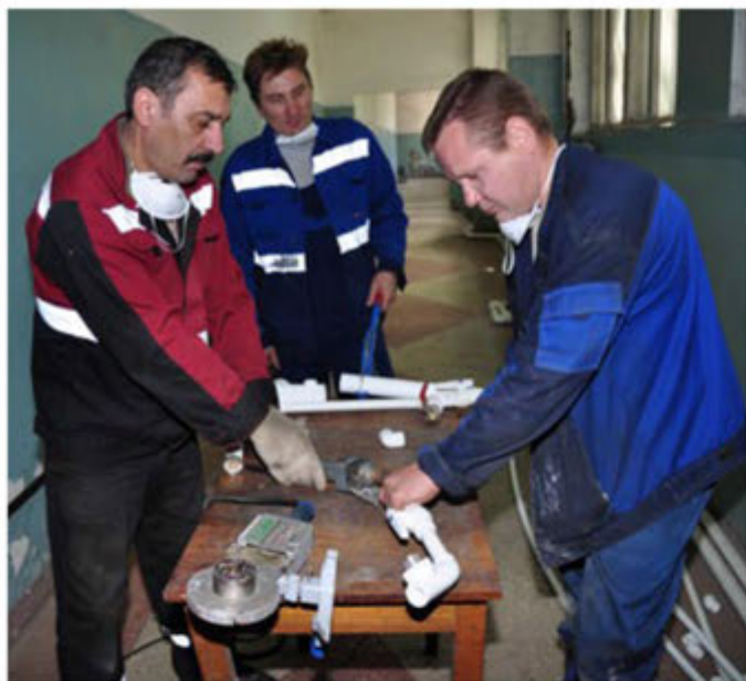
Монтаж трубопроводов полипропиленовыми трубами. На снимке — слесари АВП Владимир Мамедович Галилеев, Алексей Михайлович Канцибер и Игорь Леонидович Маренков
