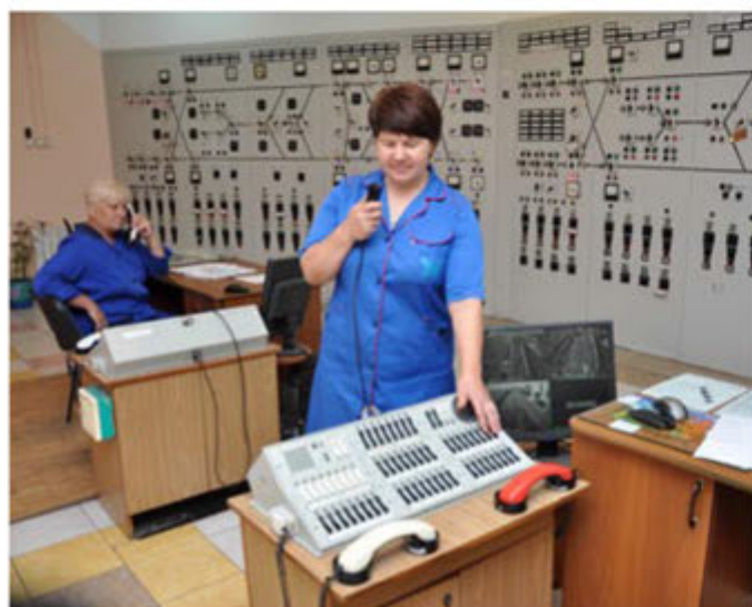
Щит управления цеха топливоподачи. Моторист автоматизированной подачи топлива для выработки электроэнергии ГРЭС Светлана Анатольевна ..... и Татьяна Филипповна Плотникова
