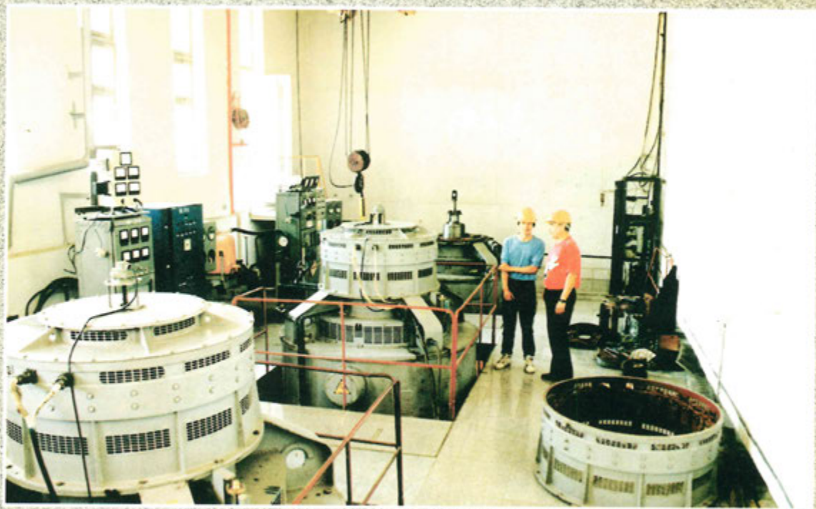
Машинный зал МГЭС-4 на реке Быстрой Быстринского района Фото А. Терещенко
