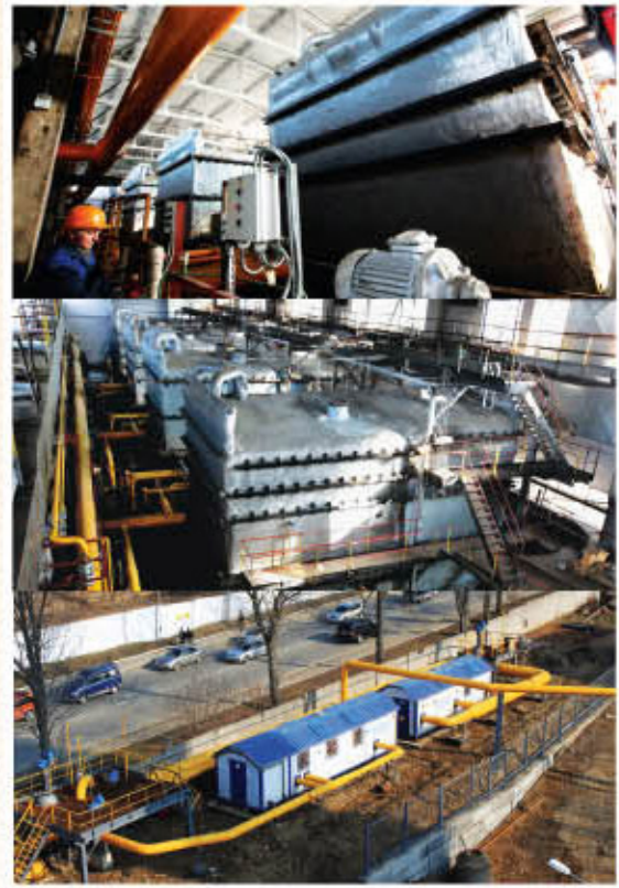
В 2012 г. цех переведен на газ
