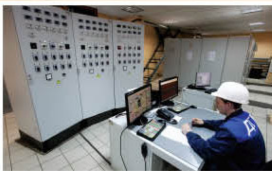
Щит управления котлами БКЗ-75
