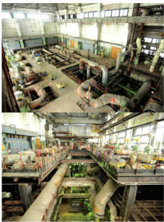
Зал подогревателей Котельного цеха № 3
