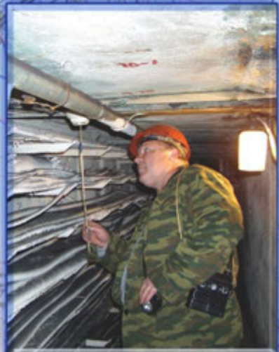
Мальшченко А.Н., эл. монтер ОПС за проверкой пожарной сигнализа ции и кабельных туннелей.
