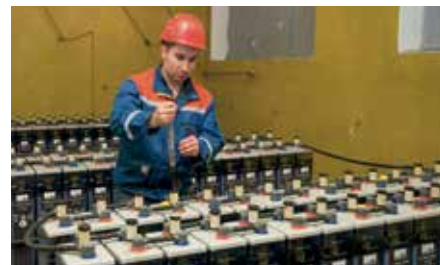
И.В Макаров, дежурный электромонтер гр. ПС. Зарядка аккумуляторов
