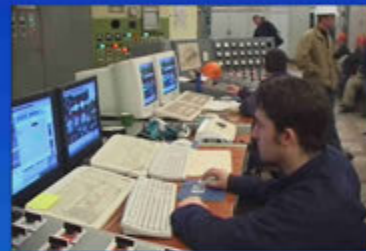
Автоматизированная система управления Турбинный цех 2004 г.
