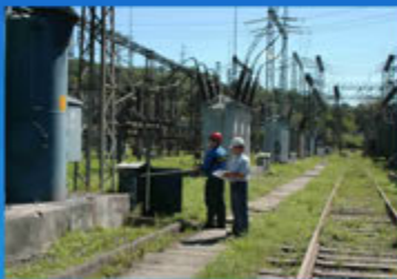
ОРУ-110 Электрический цех 2006 г.
