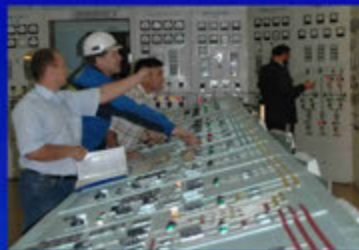
Главный щит управления
