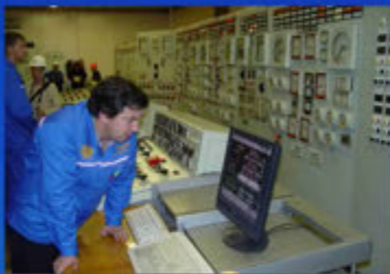
Автоматизированная система управления Котельный цех 2004 г.
