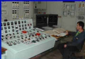
Центральный тепловой щит управления котлами №2
