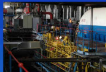
Турбинный цех. Турбогенератор №5
