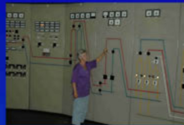
Щит управления трактом топливоподачи
