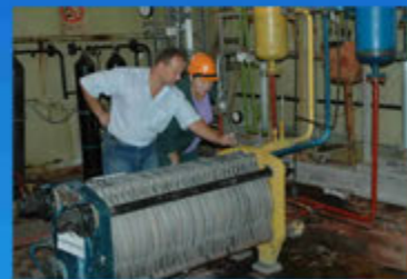
Электролизорная установка Электрический цех 2006 г.
